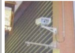
防犯カメラの設置
